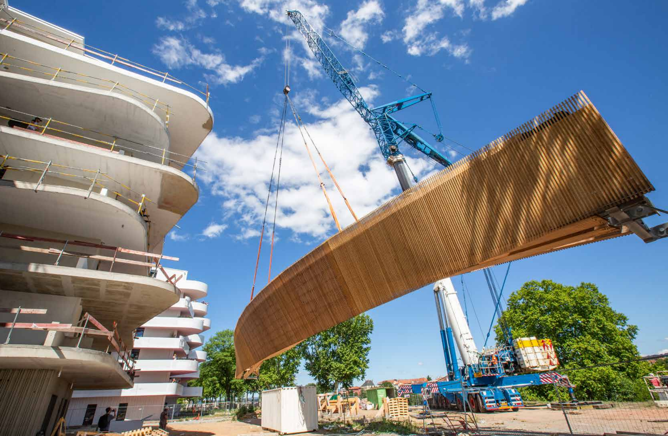
Dans le cadre du réaménagement des Bords de Loire, une large passerelle en bois a été installée entre la place Aristide-Briand et la Levée du Renaison. La structure en pin (mélèze, douglas), qui pèse 70 tonnes, enjambe désormais avec panache l'embouchure du Renaison sur 56 m. Lors de sa pose spectaculaire, une immense grue unique en Europe s'est invitée sur le chantier pour un moment suspendu !
